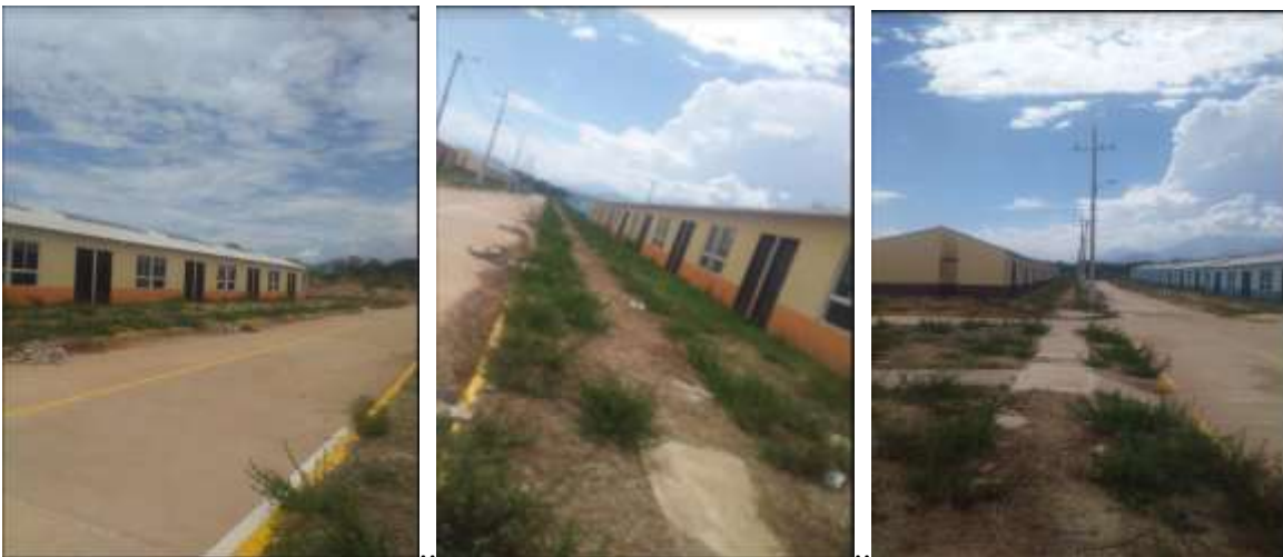
Observen la manera como los matorrales habitan los andenes
