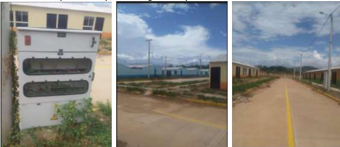
Aquí el monte penetró los gabinetes para las instalaciones eléctricas
